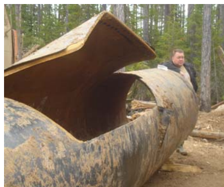
Рис. 6. Разрыв трубы после гидроиспытаний на трассе
